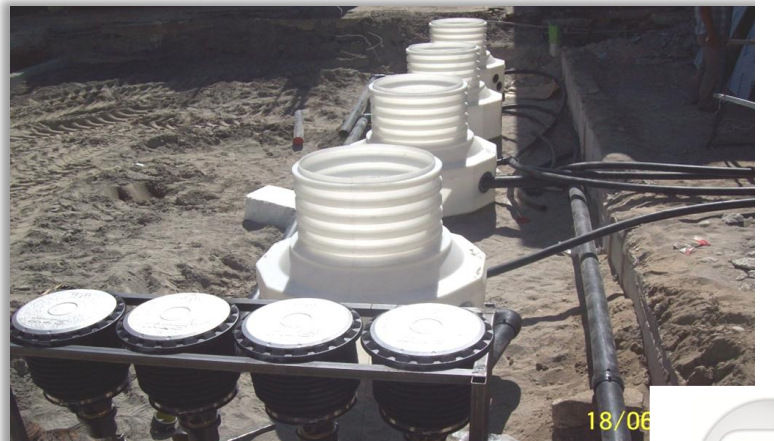
TANK ÜSTÜ SUMP –DOLUM TEŞİSATI
